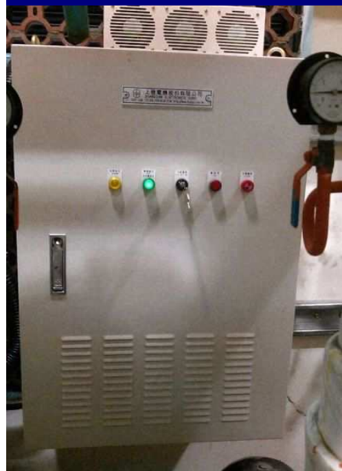
冰水泵變頻模組
