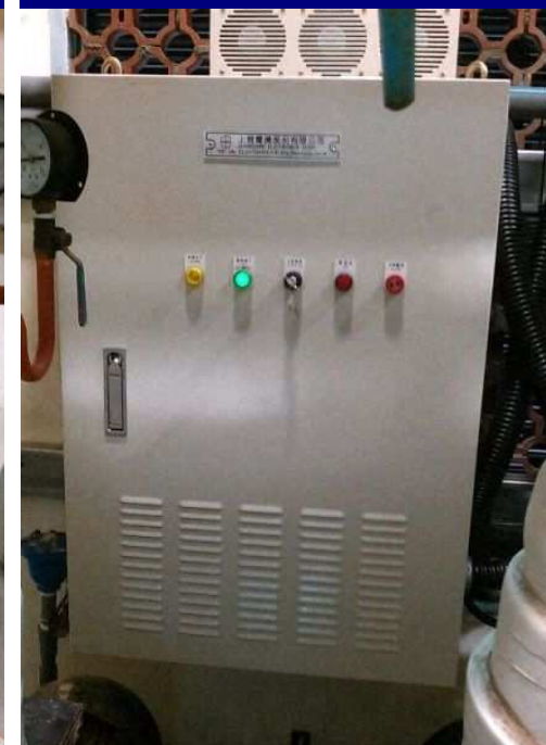
冷卻水泵變頻模組
